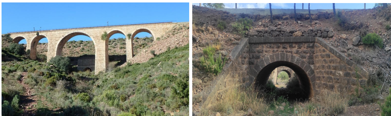
Puentes de las Vías Verde y de Renfe contruidos sobre los Barrancos de la Hoya del Agua (Izq.) y de la Moza (Dcha.)
