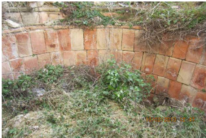
Cubo casi colmatado por la calle Muro
