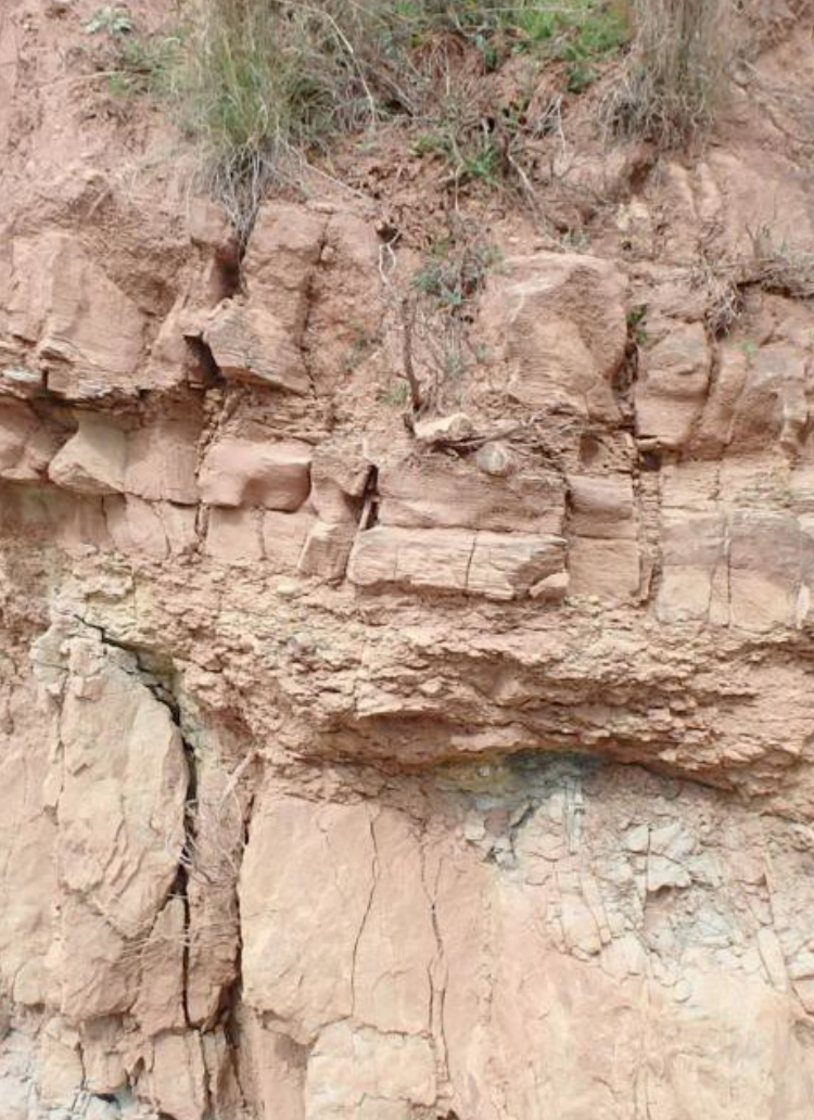
Talud donde se combinan diferentes rocas como arcillas y margas. Santa Cruz, Viver
