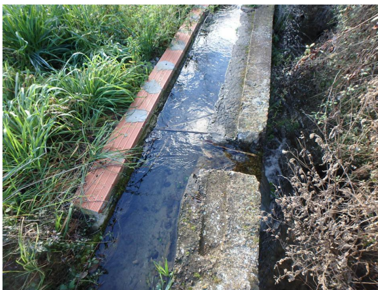
Limitador de caudal en la acequia de las Quinchas
