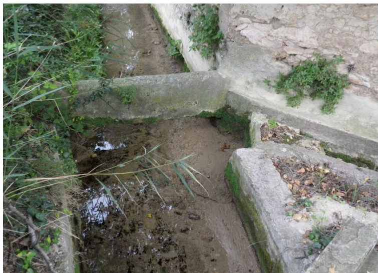
Limitador de caudal en la acequia de San Miguel, para desaguar en el Barranco Hurón
